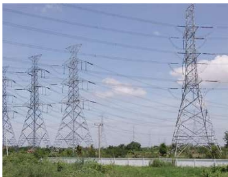
เสาไฟฟ้า
